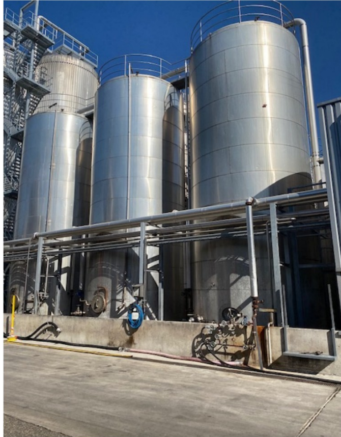
tanks waarin het spuiwater wordt opgeslagen
